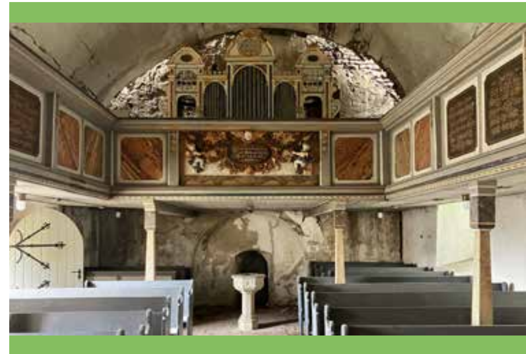
Kirche im Kirchenkreis Halle-Saalkreis (Bau im Ursprung 12. Jh.), Innenraum nach Westen, hinter dem Orgelprospekt auf der barocken Empore ist der freie Himmel sichtbar
